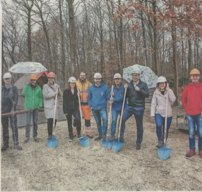
Spatenstich: (v.l.) Kilian Schmidlin, Roger Müller, Ursula Vogt, Mary Ann Born (alle EGK), Christian Richli (Chef Werkhof Laufen), Yannik Spano, Adrian Steiner (beide Müller Bau), Pascal Bolliger (EGK und Stadtrat), Alice Minghetti (Stiftung Hopp-la), Daniel Neuschwander (Technischer Dienst, Laufen). FOTO: MARTIN STAUB
