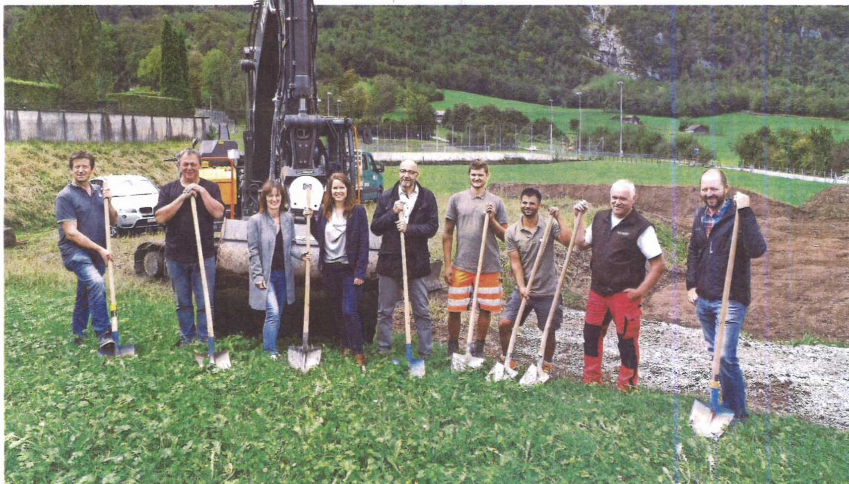
Ein Platz noch ohne Namen: Am Montag haben Vertreter der Gemeinde, der Stiftung Hopp-la und der Bauunternehmung den Spatenstich für den Begegnungsplatz getätigt.
